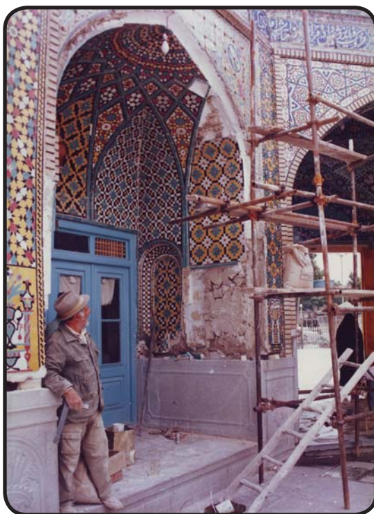
نصب ازاره های جدید در صحن اتابکی علی محمد الهی - بنای حرم مطهر تکیه به دیوار ورودی حجره
