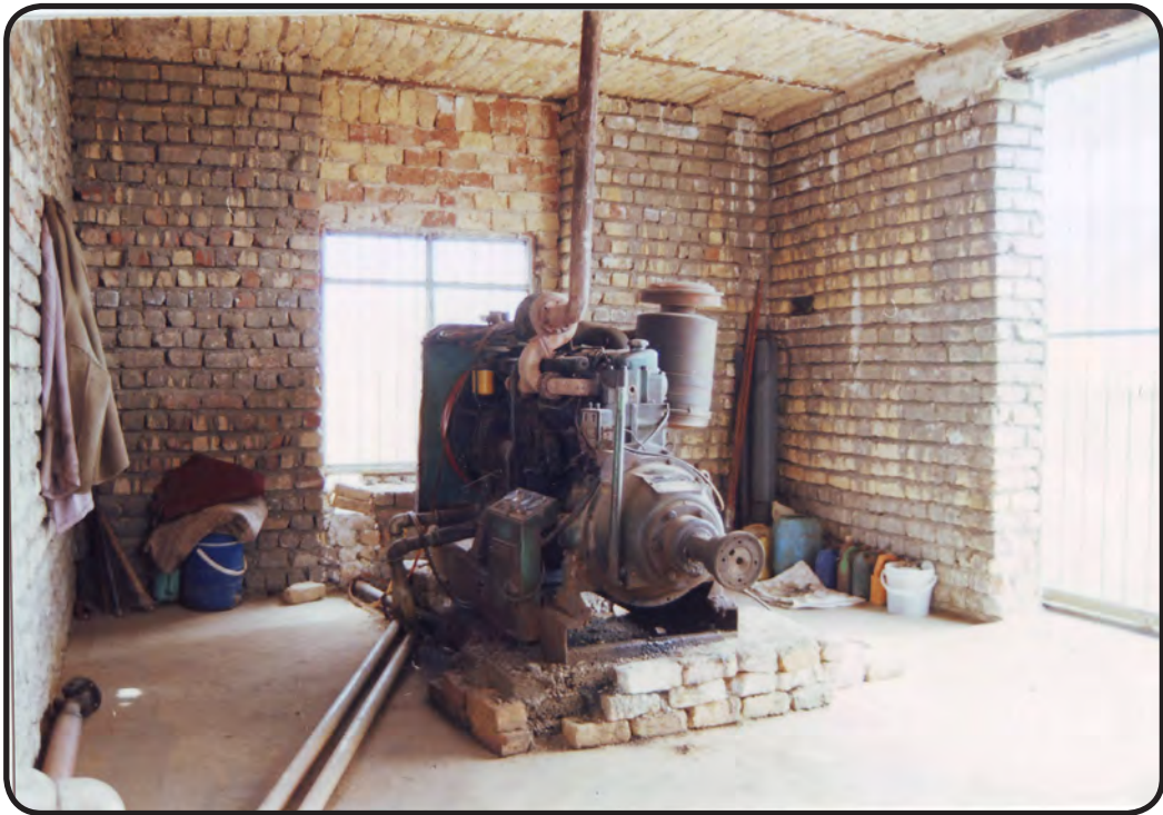
موتور خانه آب علی آباد سراجہ جهت آبیاری قطره ای محصولات کشاورزی
